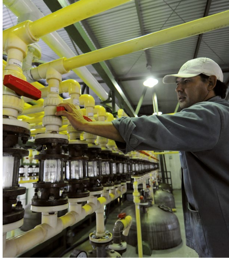
Steviolglykoside werden mittels eines chemisch-physikalischen Prozesses aus Stevia Blättern hergestellt. Diese Anlage steht in Paraguay, die meisten Produktionsstandorte befinden sich jedoch in anderen Ländern. © getty images
