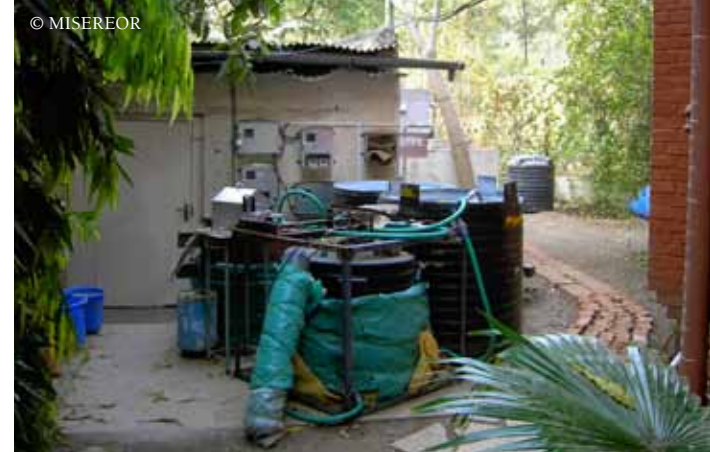
Filteranlage für Arsen-verseuchtes Wasser in Bangladesh
