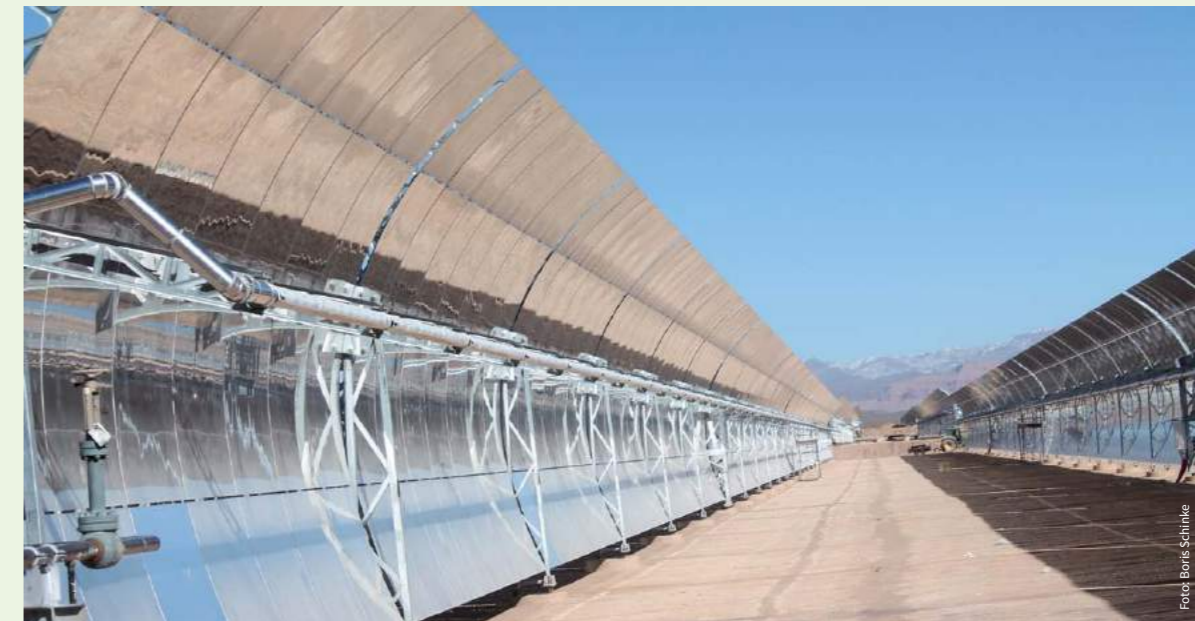
Das Großkraftwerk Noor in Marokko soll der größte solarthermische Kraftwerkspark der Welt werden.
