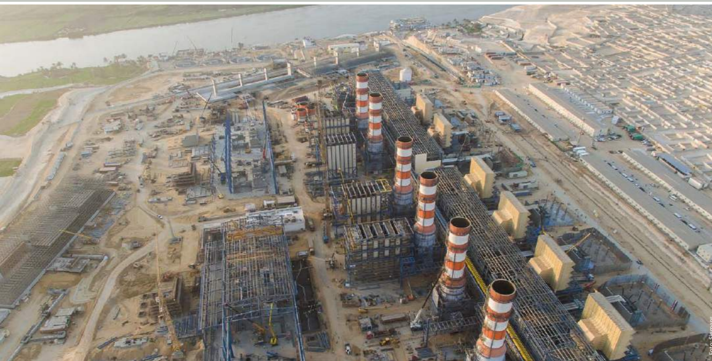
KfW Entwicklungsbank, DEG und die KfW IPEX-Bank haben zwischen 2007 und 2016 Finanzierungen für 60 Gaskraftwerksprojekte zugesagt, auch für den Großauftrag von Siemens in Ägypten.
