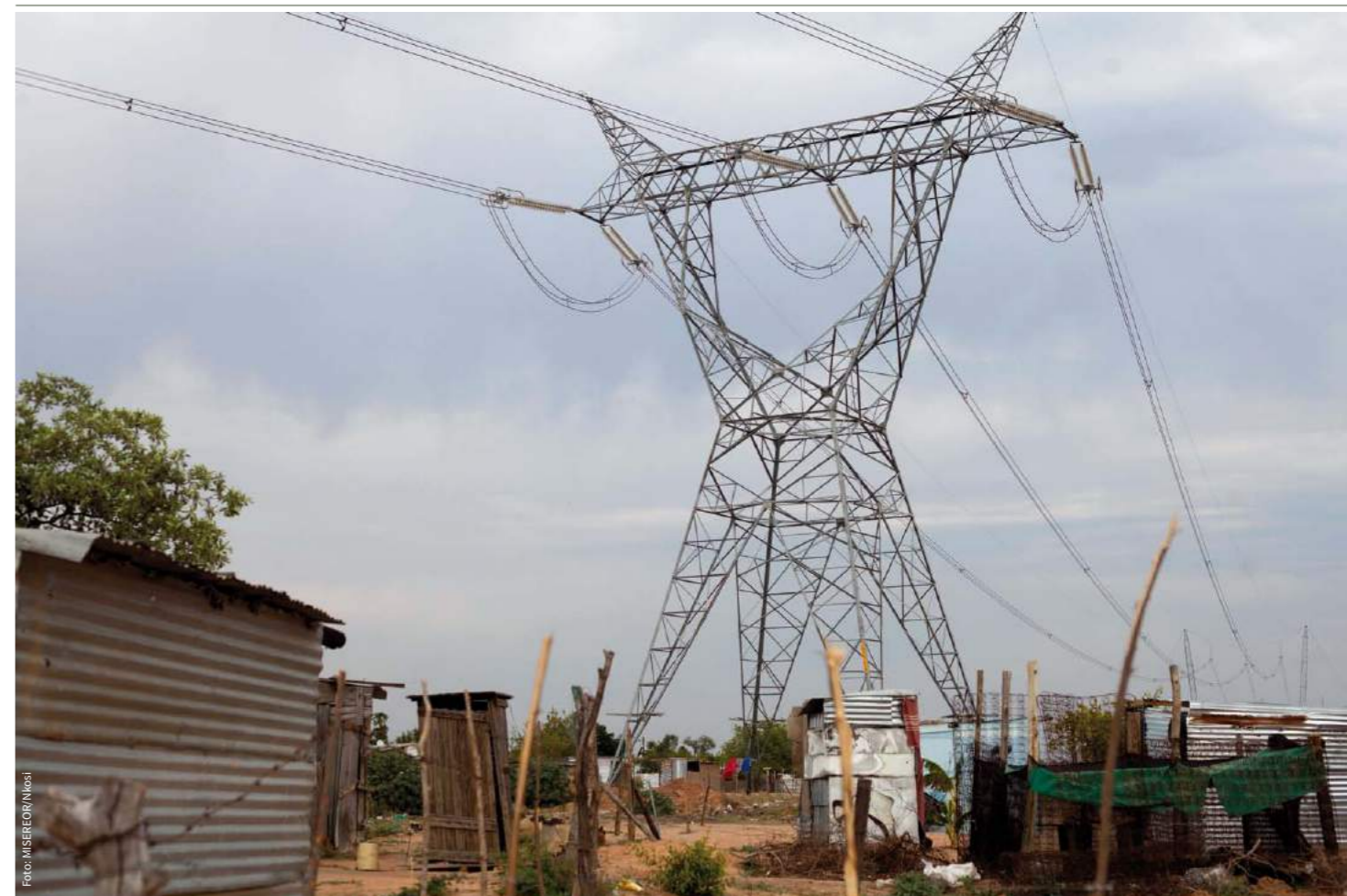
Lange Stromtrassen führen in der Nachbarschaft des Kraftwerks Medupi über die Baracken informeller Siedlungen. Gleichzeitig fehlt diesen der Zugang zu Strom.
